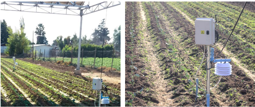
Imágenes de sistema de monitoreo instalado en terreno (Planta Lampa).
