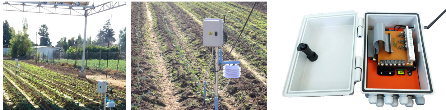
Imágenes de sistema de monitoreo instalado en terreno (Planta Lampa).
