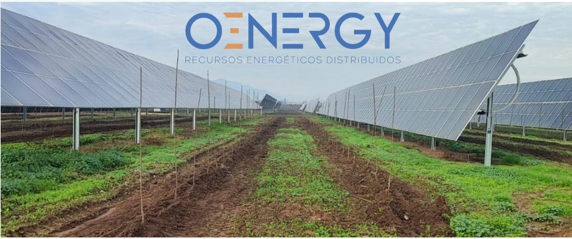
Figure 1: AV system Ayla Solar (Oenergy SpA, 2023).
