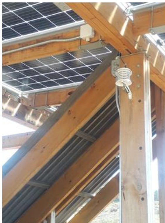
Figura 22 - 2 Sensores de temperatura ambiental
