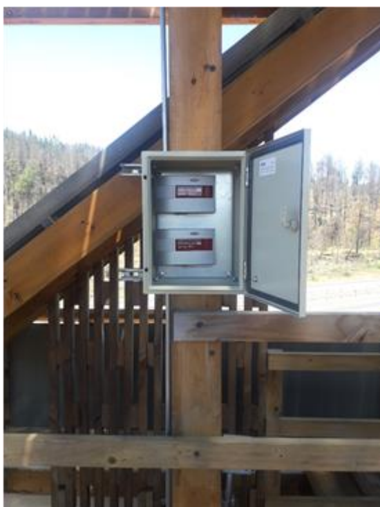
Figura 24 - Tablero eléctrico para los sensores BOX
