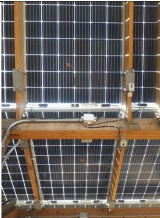
Figura 21 - 2 Sensores de temperatura en módulos PV bifaciales
