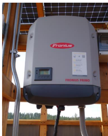
Figura 18- Inversor Fronius instalado en Torre Peñuelas
